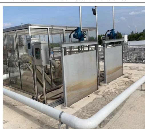
细格栅密闭及接入除臭系统废气管道
