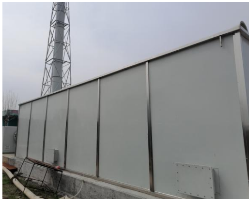
生物滤池除臭系统
