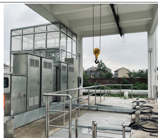
粗格栅及进水泵房
