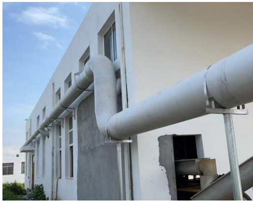
污泥脱水间接入除臭系统废气管道
